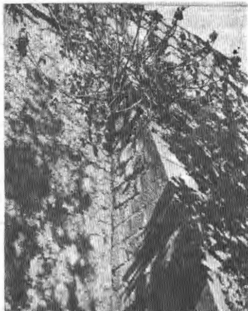
Sl. 2. Bagrem ( Robinia pseudoacacia ) kao razarač zidina (pukotina zida široka je preko 10 cm)
